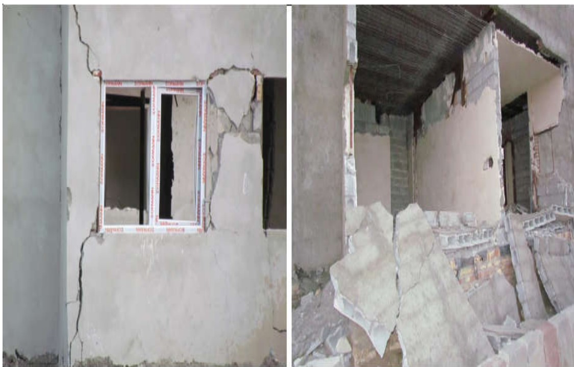
شکل ۱ - ۶ : خرابی داخلی و خارج صفحه میانقاب در زلزله اهر، هریس و ورزقان (جمعیت کاهش خطرات زلزله در ایران)
