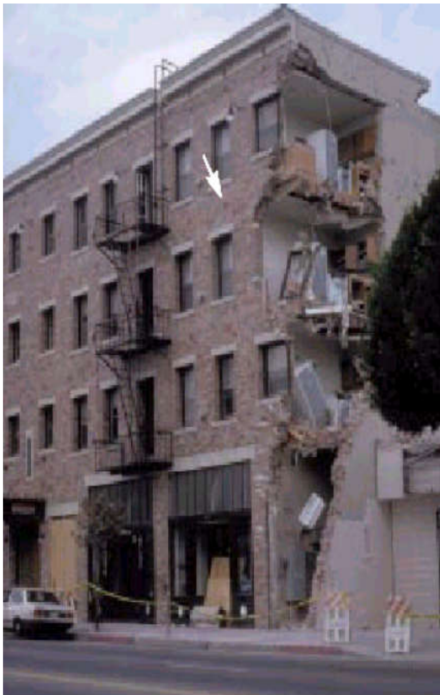
شکل ۱-۲: خسارت به دیوار خارجی ساختمان ( زلزله لس آنجلس) (محمد زاده، ۱۳۸۶)
